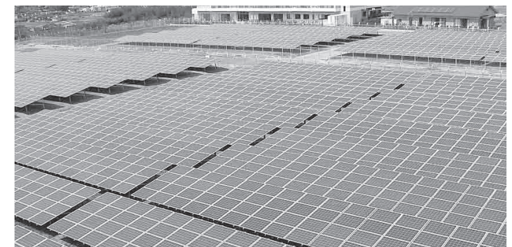
▲8,364枚の太陽光パネルが整然と並ぶ姿は圧巻
