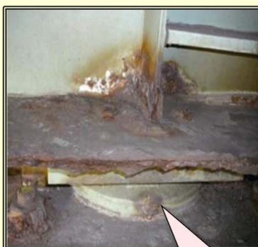
【部材健全性Ⅲ】
