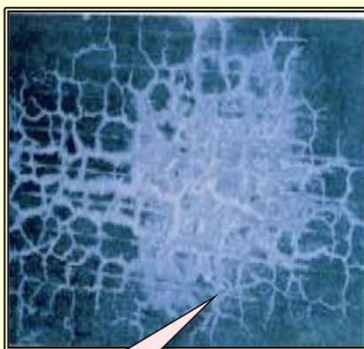
【部材健全性Ⅲ】
